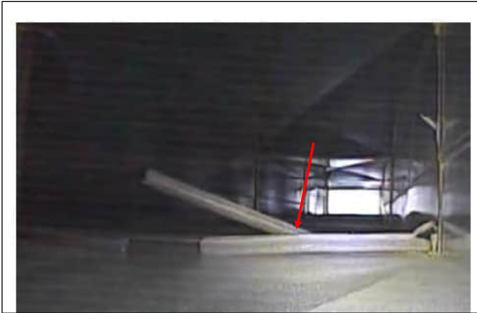
Kuva 43. Kantikkaissa kanavissa liitoksia tiivistäviä tiivisteitä oli irti useammasta kohdasta.
