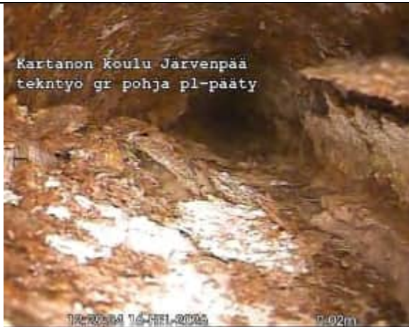
SVTV1. Voimakasta pintavauriota ja kiinteää irtokertymää teknisen työn valurautaisessa pohjaviemärissä.
