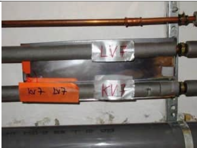
Kellarikerros, VSS-tilan käytävä; Lv-runkohaara tilan katon rajassa 18/1,0 mm
