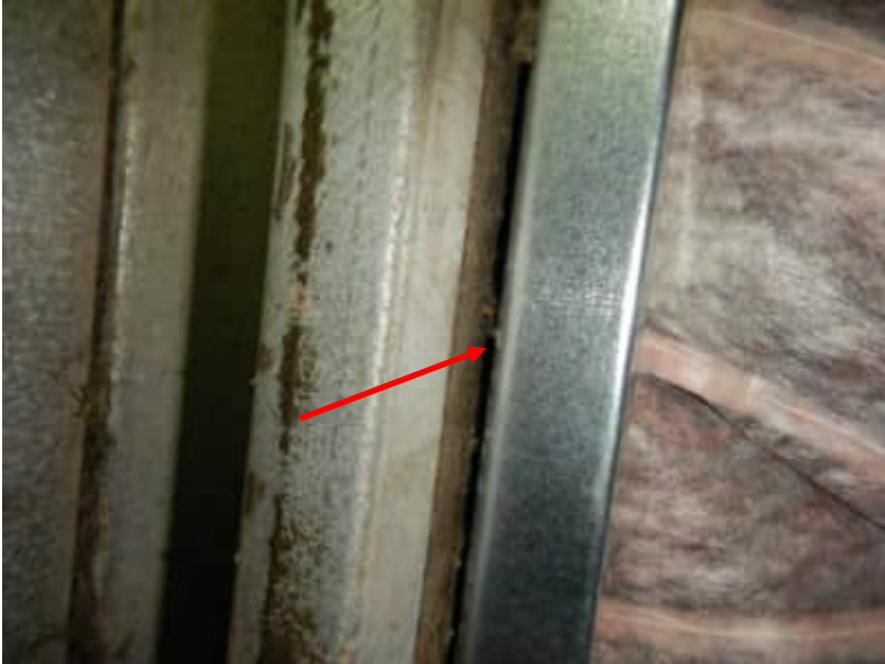
Kuva 37. Tuloilman suodatinkehikoista puuttuvat tiivisteet, minkä seurauksena suodattimien ohi tapahtuu ohivirtausta.
