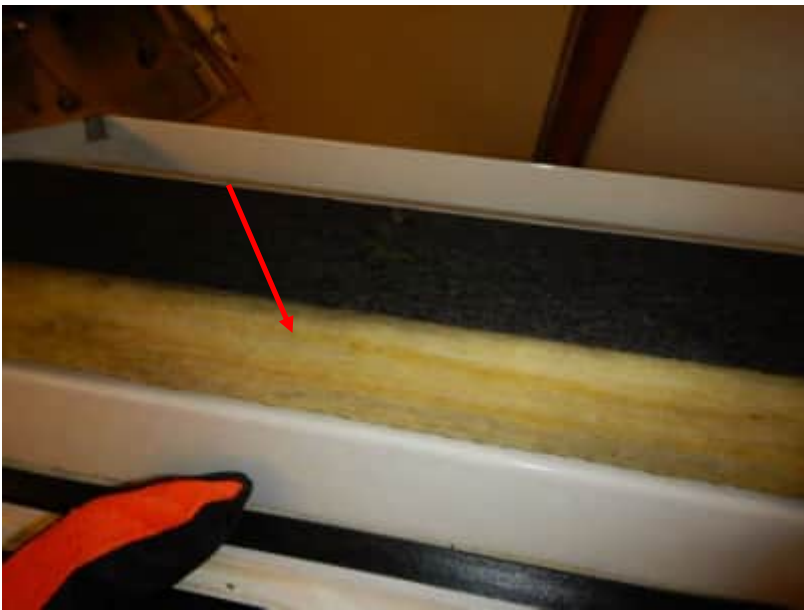
Kuva 54. Alkuperäisten tuloilmaelimiä tasauslaatikoiden sisällä on suojaamatonta mineraalivillaa.
