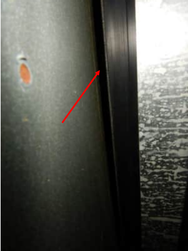
Kuva 20. Lämmöntalteenottokiekon sivuharjat ovat kuluneet pois.
