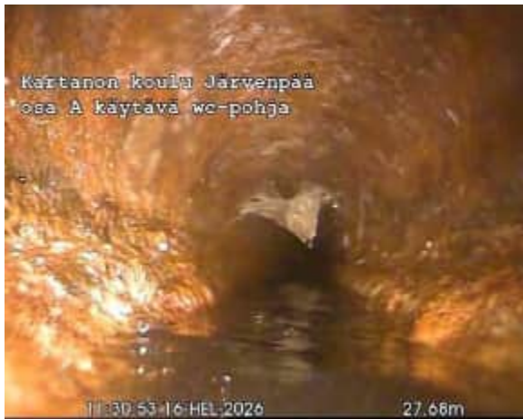
JVTV5. Pintavauriota osan A valurautaisessa pohjaviemärissä.
