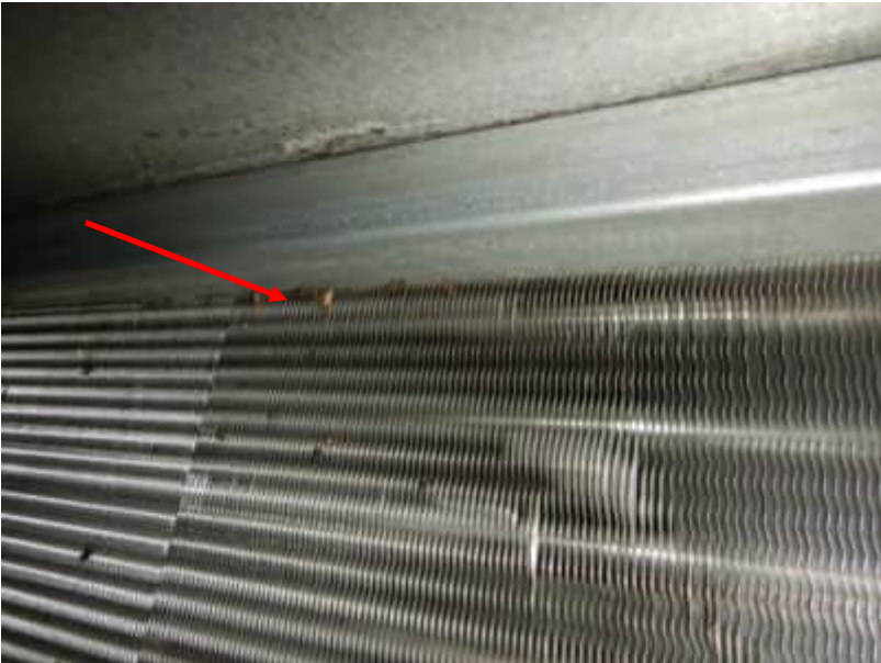
Kuva 27. Lämmityspatterissa havaittiin kolhuja sekä epäpuhtauksia.
