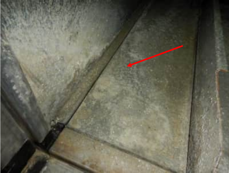
Kuva 22. Tuloilmakammiossa havaittiin kosteusjälkiä ja likaantumista.
