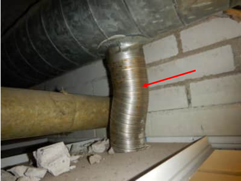
Kuva 41. Pääte-elimien kytkennöissä on käytetty 1970-luvun lopun rakennusosalla myös joustavaa alumiinikanavaa.
