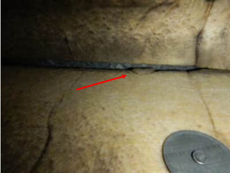
Kuva 53. Alkuperäisten tuloilmaelimiä tasauslaatikoiden sisällä on suojaamatonta mineraalivillaa.
