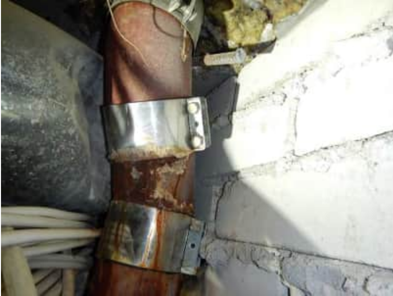
Kuva 13. Pantaliitetyssä valurautaviemärissä on havaittavissa vuotojälkiä.
