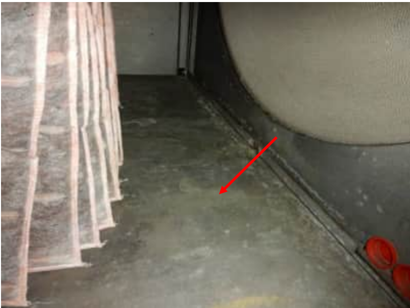
Kuva 16. Suodatuskammiossa havaittiin kosteusjälkiä sekä ulkoilman epäpuhtauksien aiheuttamaa likaantumista.
