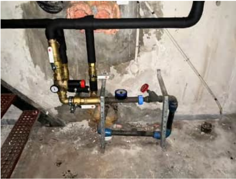
Kuva 6. Yleiskuva pääsuluista ja vesimittareista (vanha osa).
