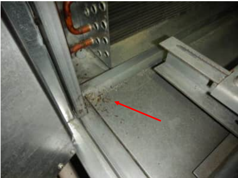
Kuva 18. Tuloilmakoneen puhallinkammio on likainen.
