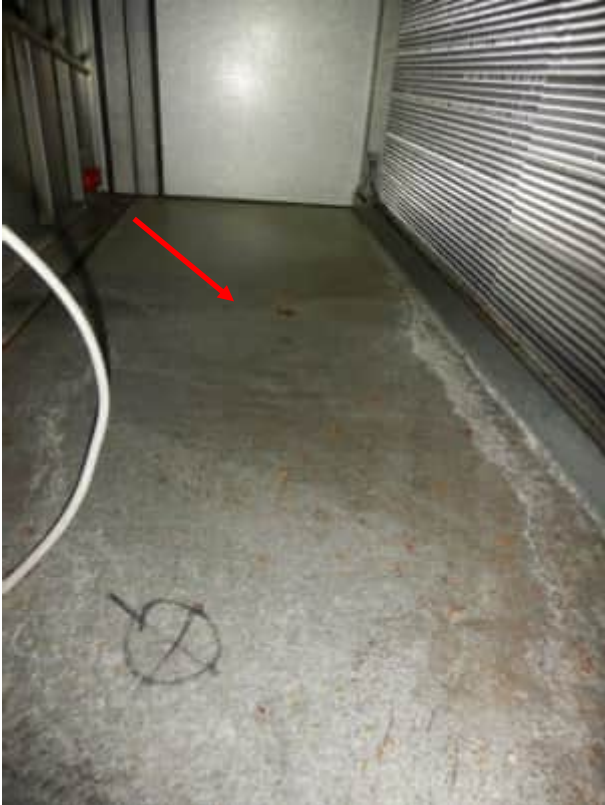
Kuva 26. LTO-patterin jälkeisessä kammiossa havaittiin likaa ja asennusaikaista metallimurua.
