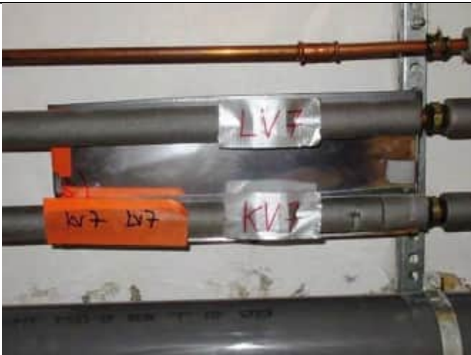
Kellarikerros, VSS-tilan käytävä; Kv-runkohaara tilan katon rajassa 18/1,0 mm
