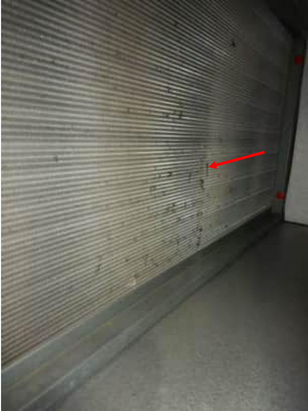
Kuva 32. Lämmityspatterissa havaittiin epäpuhtauksia.
