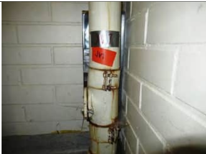
1. kerros, Siivouskomerotila ison aulatilán vierustalla; Jv-viemäriinjan pystyputkiosat tilán seinustalla lähellä lattiaa rajaa 110/5,0 mm
