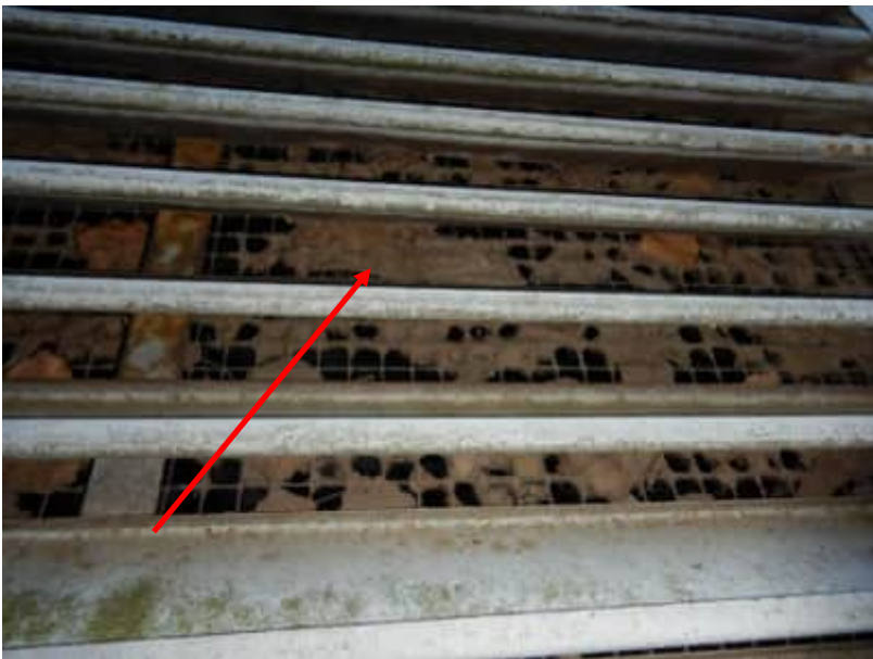
Kuva 29. Ulkosäleikkö on osittain tukkeutunut.
