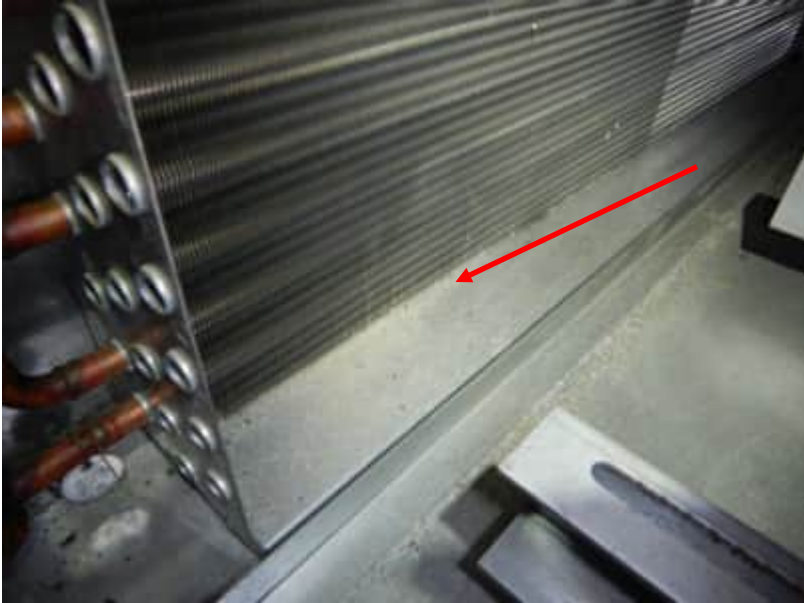
Kuva 17. Lämpöpatterin läpi on kulkeutunut likaa.
