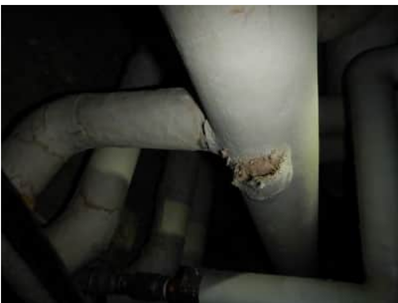
Kuva 4. Vanhoissa eristeissä on havaittavissa pinnoitevaurioita (todennäköisesti asbestia).
