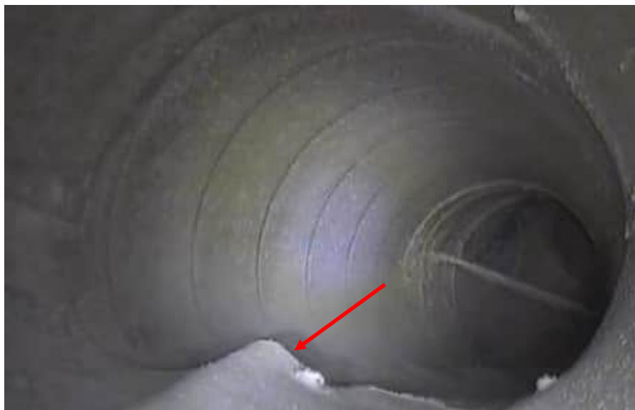
Kuva 47. Kanavissa havaittiin muodonmuutoksia niin tulo- kuin poistokanavissa B-osalla.
