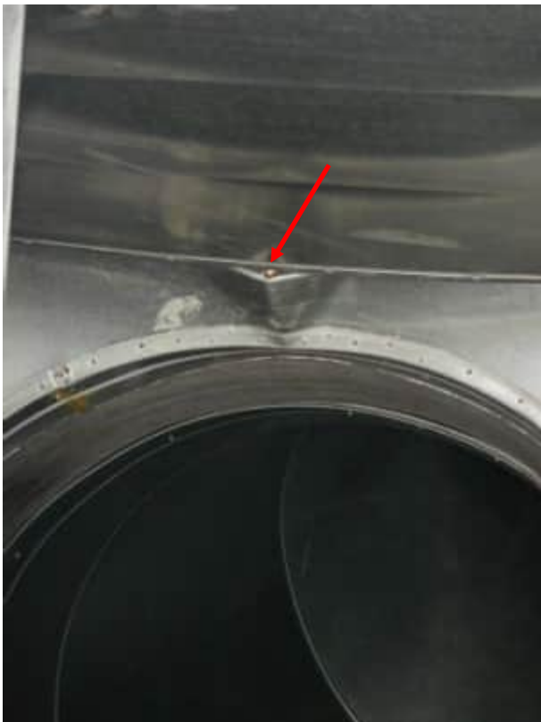
Kuva 38. Tuloilman jakokammiossa havaittiin ilmapuotoja ja rakoja rakenteissa.
