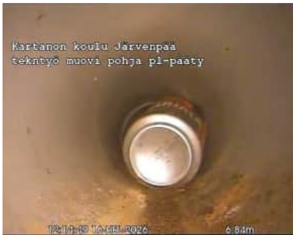
JVTV7. Ylimääräinen esine teknisen työn muovisessa pohjaviemärissä.
