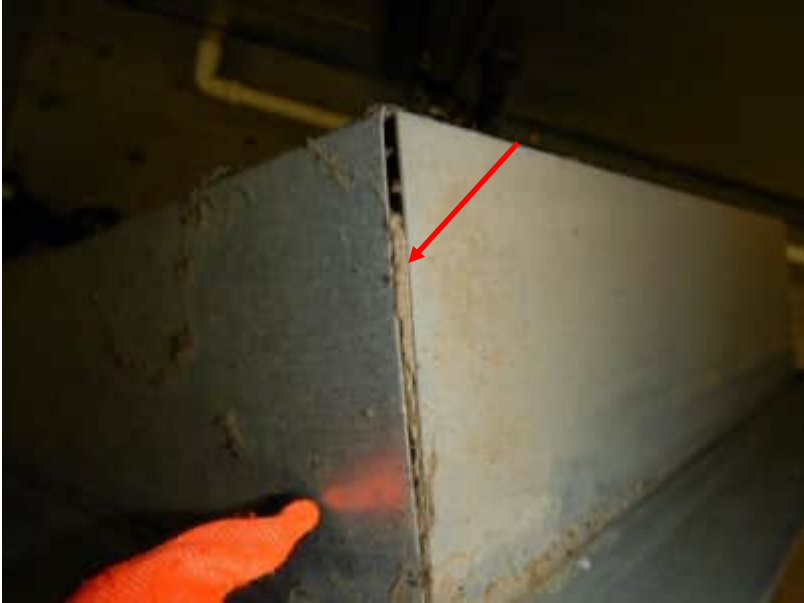
Kuva 15. Raitisilmakammion huoltoluukussa on suojaamatonta mineraalivillaa.
