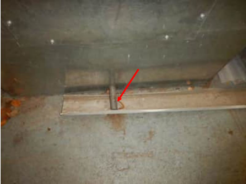
Kuva 35. Raitisilmakammion kondenssivesiviemäristä puuttuu pallohajulukko tai vastaava hajulukollinen ratkaisu.
