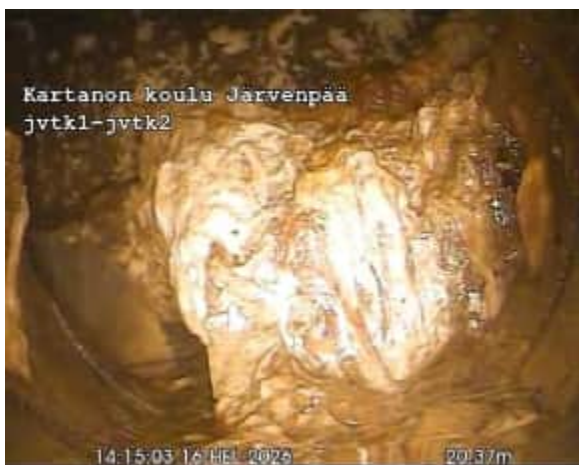
JVTV11. Paperitukos tarkastuskaivossa JVTK2.
