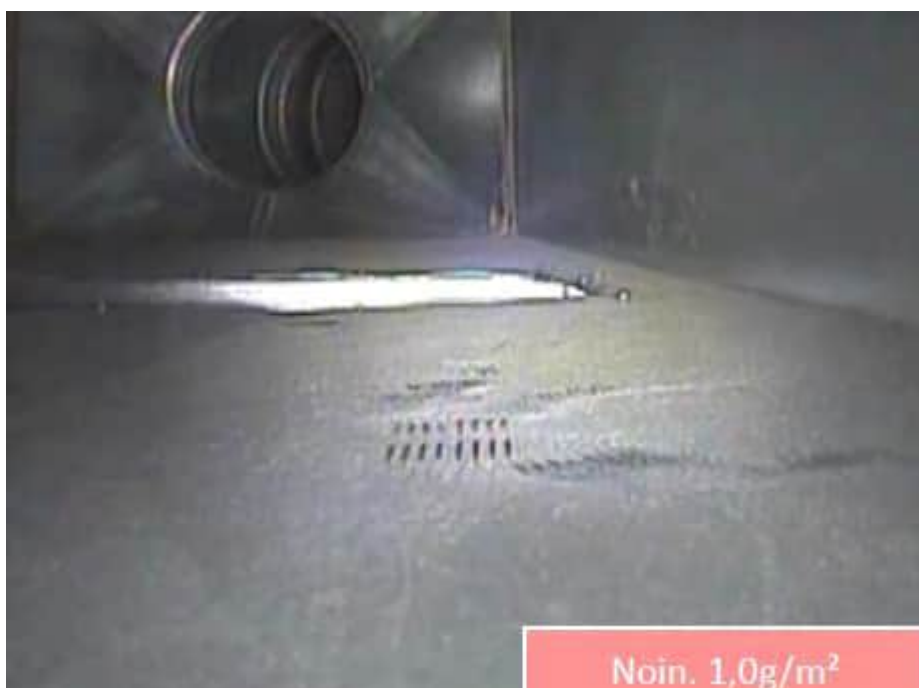
Kuva 48. Kanavakuvauksen perusteella tuloilmakanavissa on havaittavissa pölykertymää vaihtelevasti ja keskimäärin noin 1,0 \text{ g/m}^3 , mikä ylittää P1-puhtausluokituksen tason (RT103807 mukaan käytössä olevan ilmanvaihtojärjestelmän sisäpinnan pölykertymän keskiarvo saa olla enintään 0,7 \text{ g/m}^3 ).
