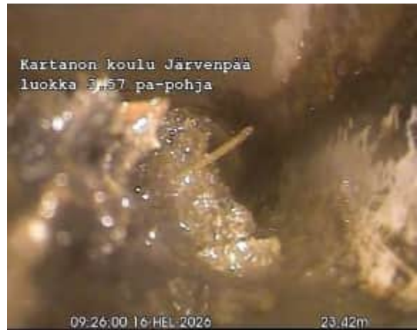
JVTV4. Irtokertymää päärakennuksen pohjaviemärissä.
