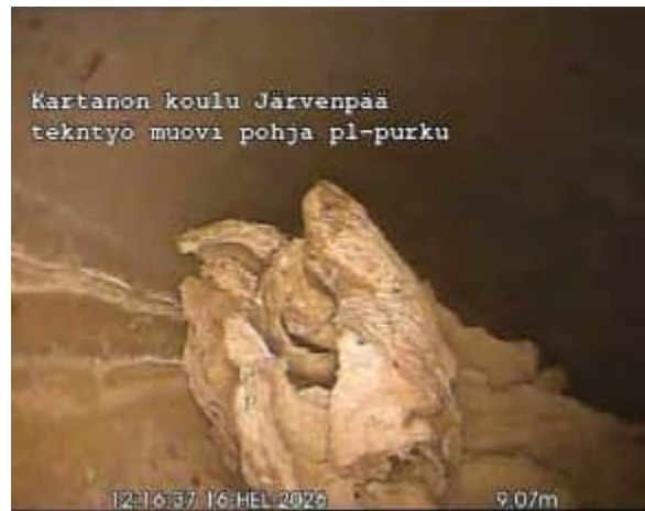
JVTV8. Irtokertymää teknisen työn muovisessa pohjaviemärissä.
