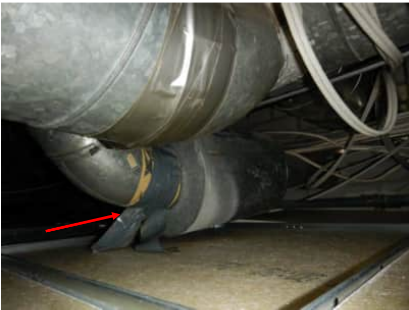
Kuva 44. Tiivistenauhat olivat irtolleet vanhoilla osilla.
