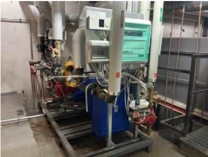
Kuva 1. Yleiskuva lämmönjakoalakeskuksesta (vanha osa).
