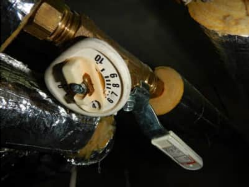
Kuva 9. LVK-verkoston venttiileissä ei ole säätökilpiä, mutta virtaamia on ainakin paikallisesti säädetty.
