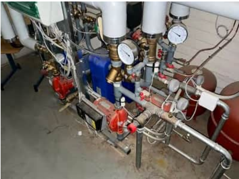
Kuva 2. Yleiskuva lämmönjakoalakeskuksesta (laajennusosa).
