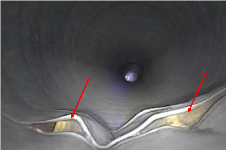
Kuva 45. Poistokanavassa havaittiin reikä
