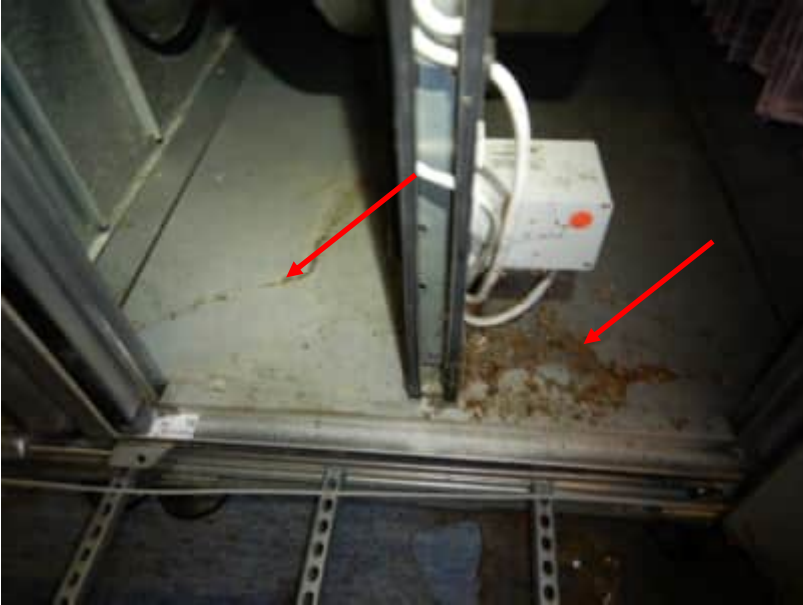
Kuva 30. Lämmöntalteenottokennon jälkeisessä kammiossa havaittiin likaa.
