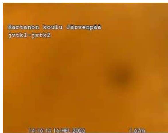
JVTV11. Vesitäyttöä / painumaa (kamera sukeltaa) tarkastuskaivojen JVTK1 ja JVTK2 välisessä putkilinjassa.
