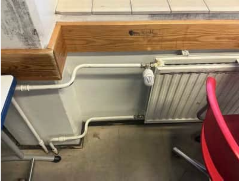
Kuva 5. Yleiskuva lämpöpattereista ja termostaattisista patteriventtiileistä.
